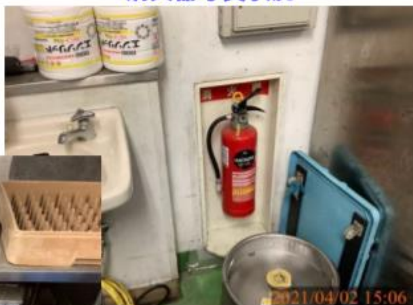
消火器写真状況
