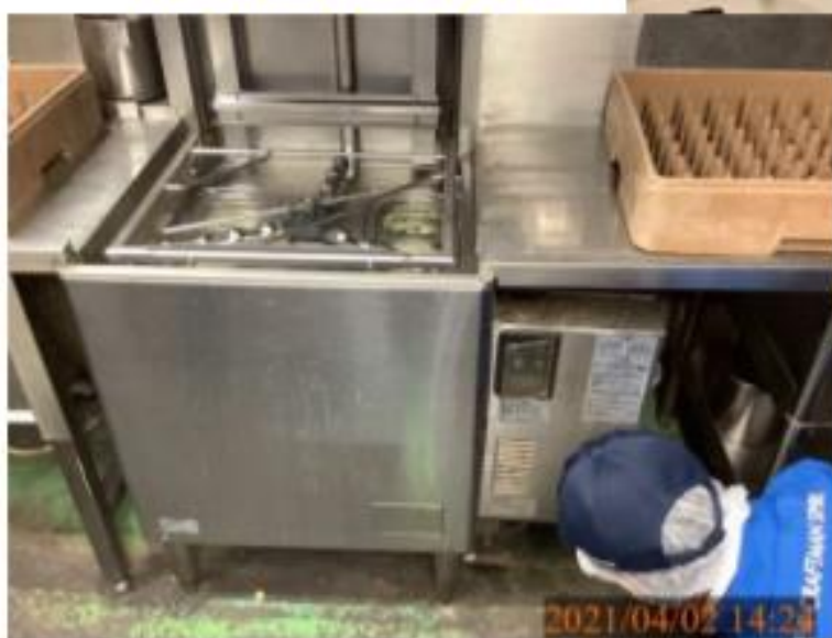
ガス設備写真状況
