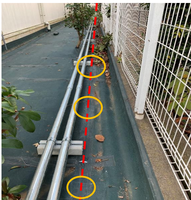
埋設管ルート、配線損傷箇所
