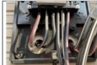
電力計二次側接続
