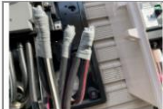
二次側接続状況
