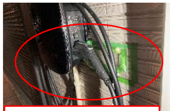
応急対応 : シーリング処置 ※充電時にケーブルにシーリング材が付着する懸念のためテープ養生を
