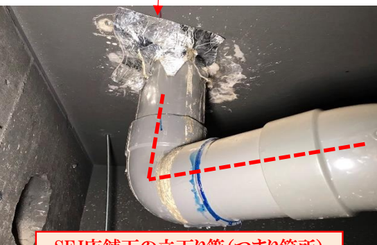
SEJ店舗下の立下り管(つまり箇所)
