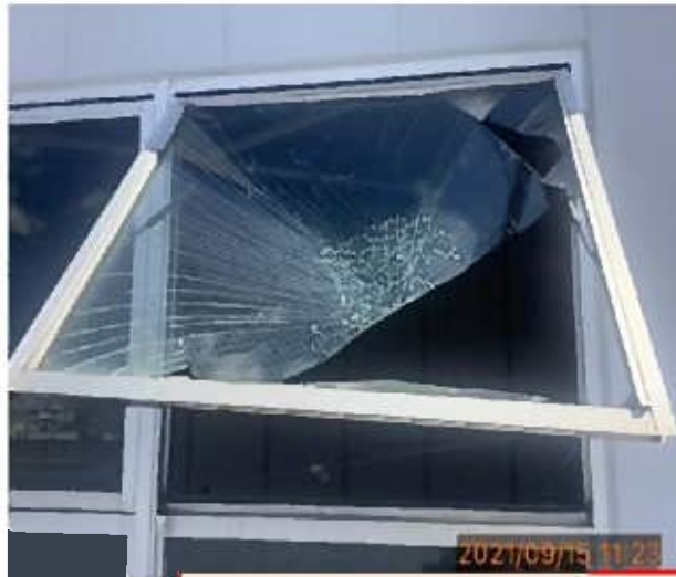
ガラス破損状況
