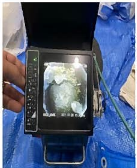
28日経リ状況(管内汚泥)
