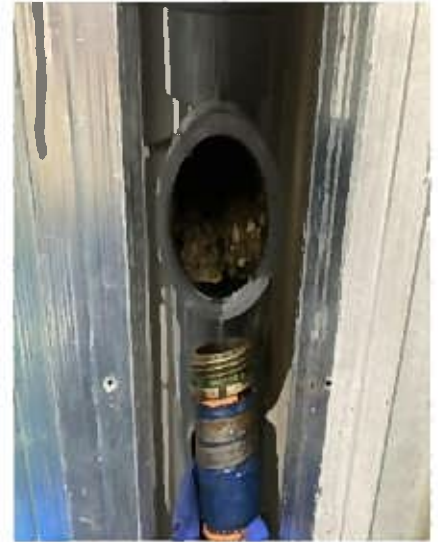
排水後蓄積物状況
