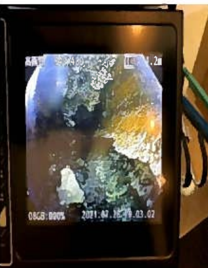
埋設配管腐食状況
