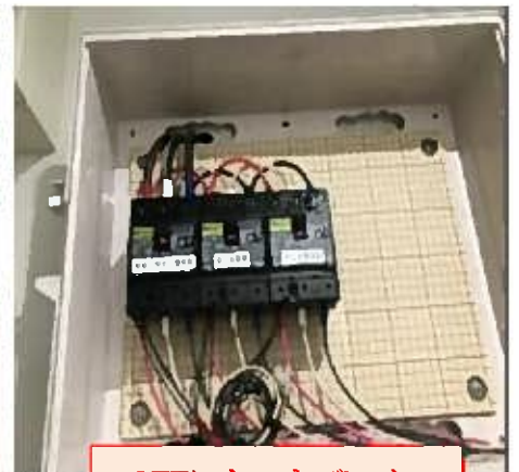
OFFになったブレーカー
