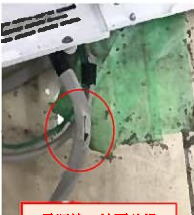
電源線の被覆破損
