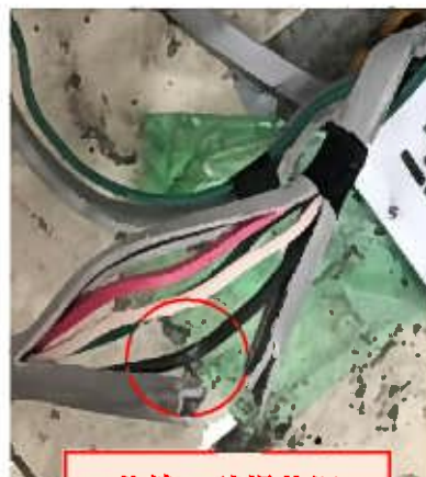
芯線の破損状況
