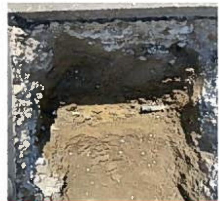
破損した埋設給水管
