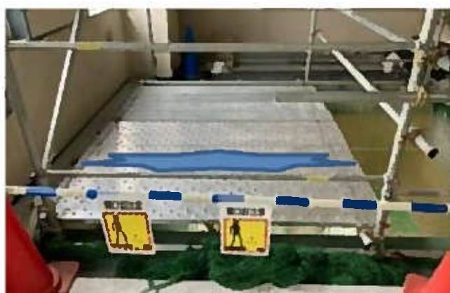
2階 足場板落下 場所近景(1枚落下)
